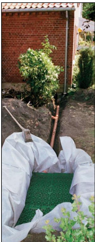
Figur 25. Mindre kassetmagasin för fördröjning av takvatten
